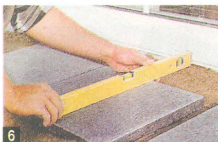
6 Уклон проверяют с помощью уровня. Плиты располагают ниже водосточного жёлоба, расположенного перед дверью.
